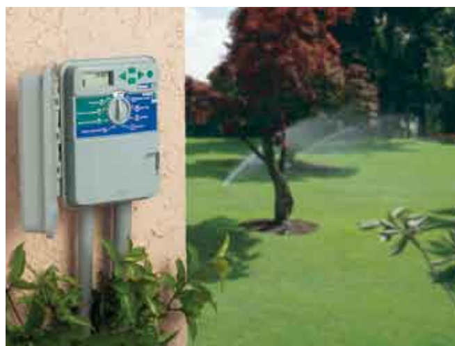
Ein automatisches Steuergerät speichert Informationen, an welchen Tagen zu bewässern ist, um welche Uhrzeit die Bewässerung beginnen soll und wie lange jede einzelne Zone bewässert werden soll.
